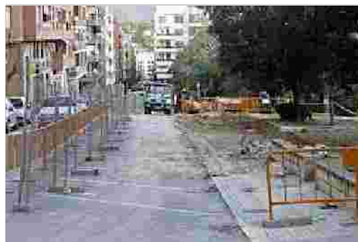
Obras en la calle Pío XII en la que han eliminado varias plazas de aparcamiento para ampliar las aceras.
